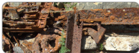
Figura 4. Hierro oxidado. Proceso de cambio químico
